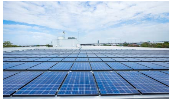
Fabrikdach mit Solaranlage, © fotolia_kinwun
